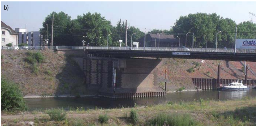
Bild 4. a) Neuplanung über Bestand; b) Bestand Widerlager Klappbrücke Fig. 4. a) New design in connection with existing construction; b) Existing abutments of the bascule bridge
